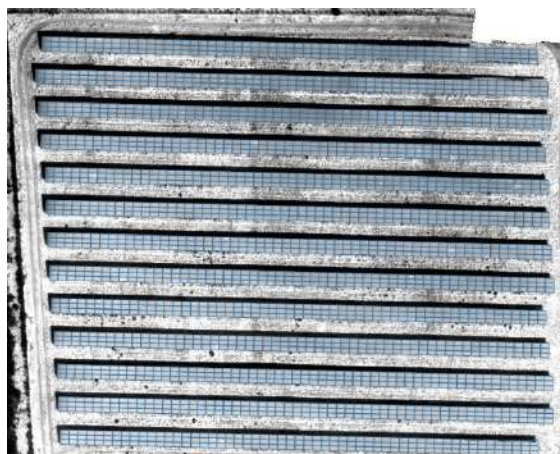
Figura 16 Porzione di impianto analizzata nel secondo sorvolo, corrispondente all'inverter 4.
